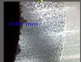
Desconchado en el revestimiento
